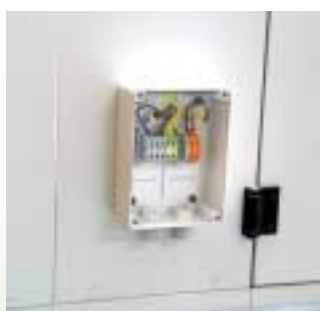
электроподключения выведены на специальный щит
