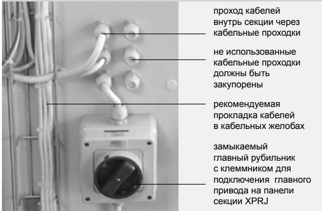
Рис. 28 – кабельные выходы секции
